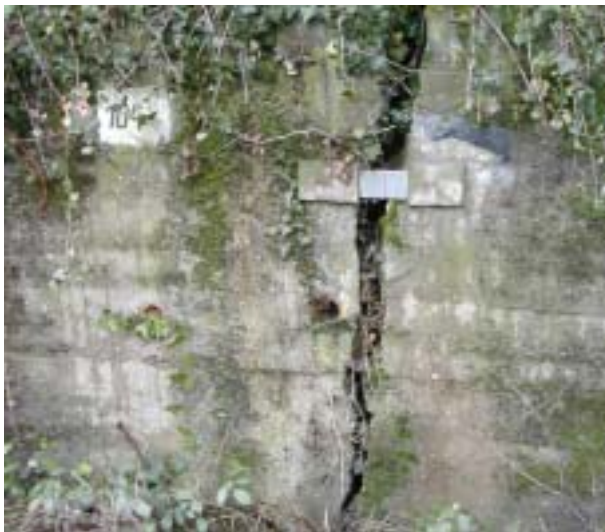
Bild 10: Riss in Betonstützmauer, aus KRAUTER & LAUTERBACH, 2004
