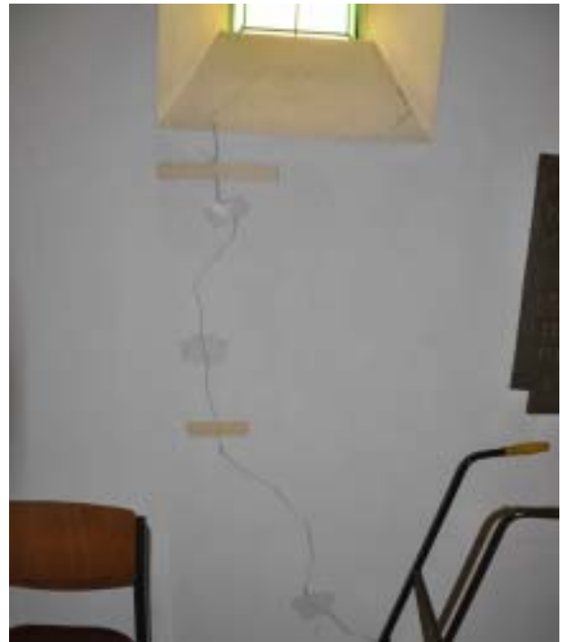
Bild 17: Rissbildung in der Wand der Kreuzkapelle, Aufnahme vom 28.03.2010
