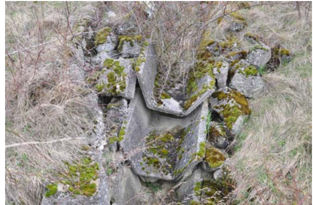
Bild 19: Zerstörter mit Trapezschaalen eingefasster Entwässerungsgraben, Aufnahme vom 28.03.2010
