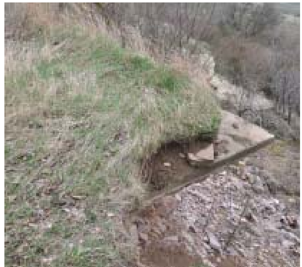
Bild 18: Zerstörter Weg, Aufnahme vom 28.03.2010
